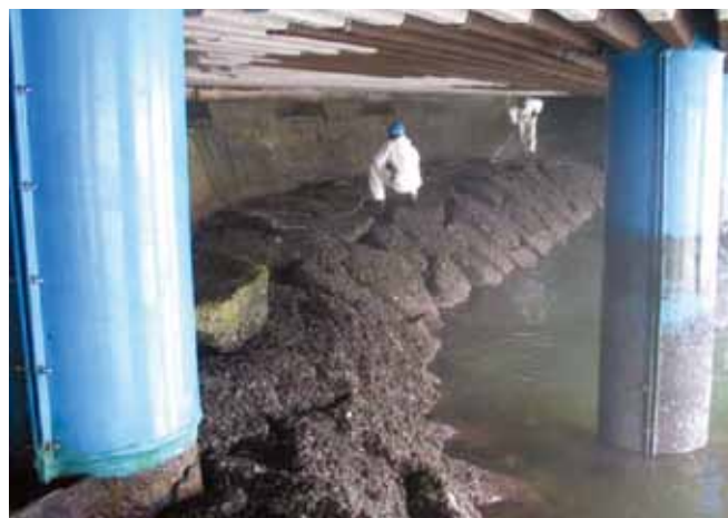
▲ 图 31：由于头顶空间不足且缺少通风，因此对于清理人员而言，进入码头下方可能会很困难且有危险。
