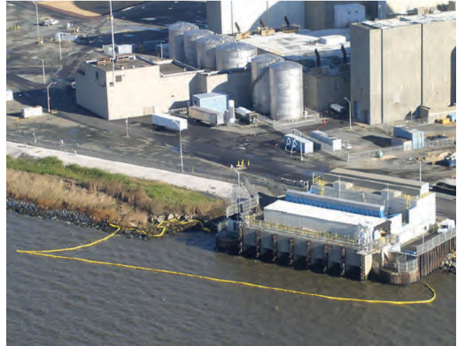
▲ 그림 13: 발전소 취수구 앞에 설치된 커튼형 오일펜스
