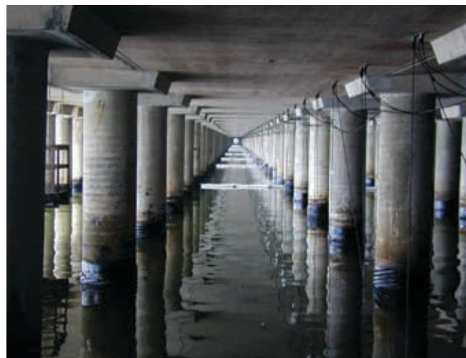
▲ Рис. 5: Ввиду ограниченной высоты рабочего пространства и недостаточной вентиляции условия проведения работ по очистке участка под причалами могут быть сложными и опасными.
