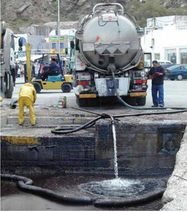
▲ Şekil 15: Toplanan yağlı suyun bir vakum kamyonunda oturması ve ayrılmasından sonra kazara dökülme alanında suyun boşaltılması.
